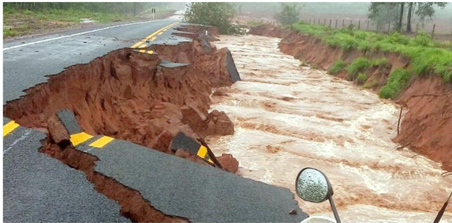
Figura 15: Erosão na MT 020
