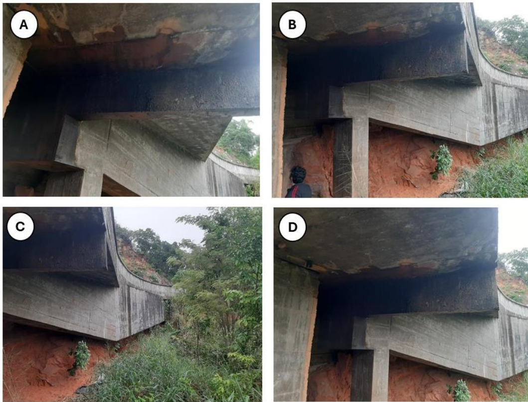
Figura 43: (A) Detalhe da infiltração oriunda da junta de dilatação e água superficial; (B) Detalhe da infiltração oriunda da junta de dilatação e água superficial; (C) Detalhe da infiltração oriunda da junta de dilatação e água superficial; (D) Detalhe da infiltração oriunda da junta de dilatação e água superficial.
